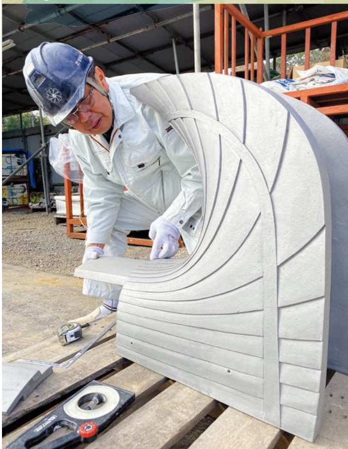
お寺の屋根に取り付ける鴟尾(しび)の仕上がりを確認する松枝さん。鴟尾とは棟の両端につける装飾瓦。この鴟尾はオーダーメイドで三州(愛知県)の職人の手によって作られた
